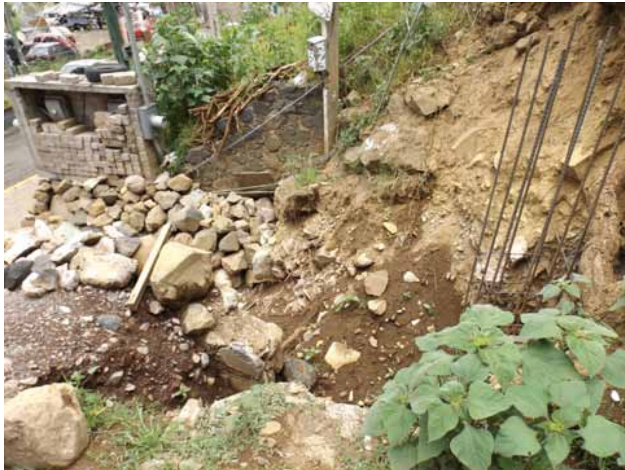
Figura VII.8. Inmueble en obra negra localizado al pie del talud, sobre el cual se presenta material deslizado por efectos de gravedad, se observa el tipo de material representativo de la zona de estudio y las características físicas que lo identifican; como la poca consolidación, angulosidad y tamaño de grano.
