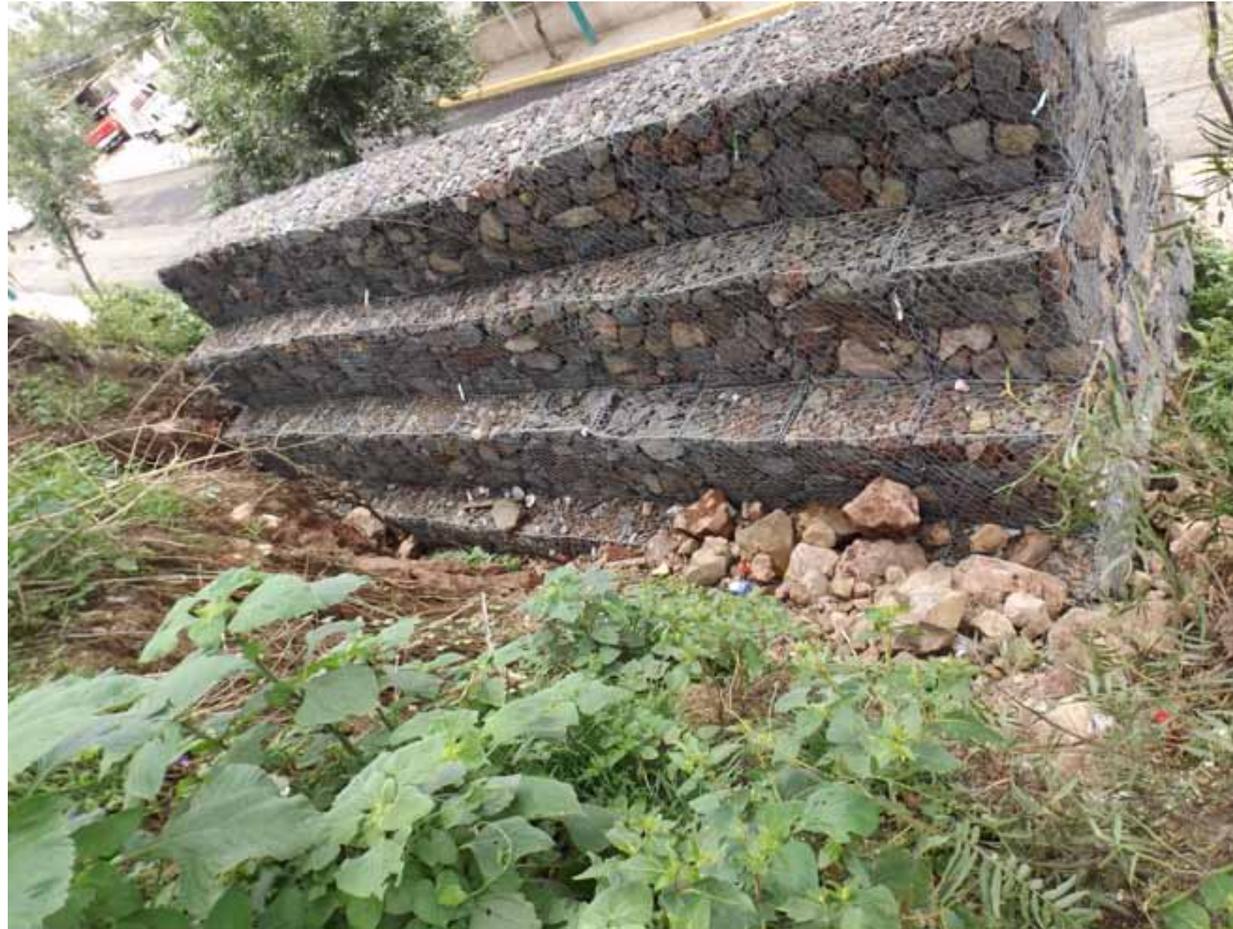
Figura VII.12. Muro de gavión que eventualmente soporta la caída de material de tamaño considerable.
