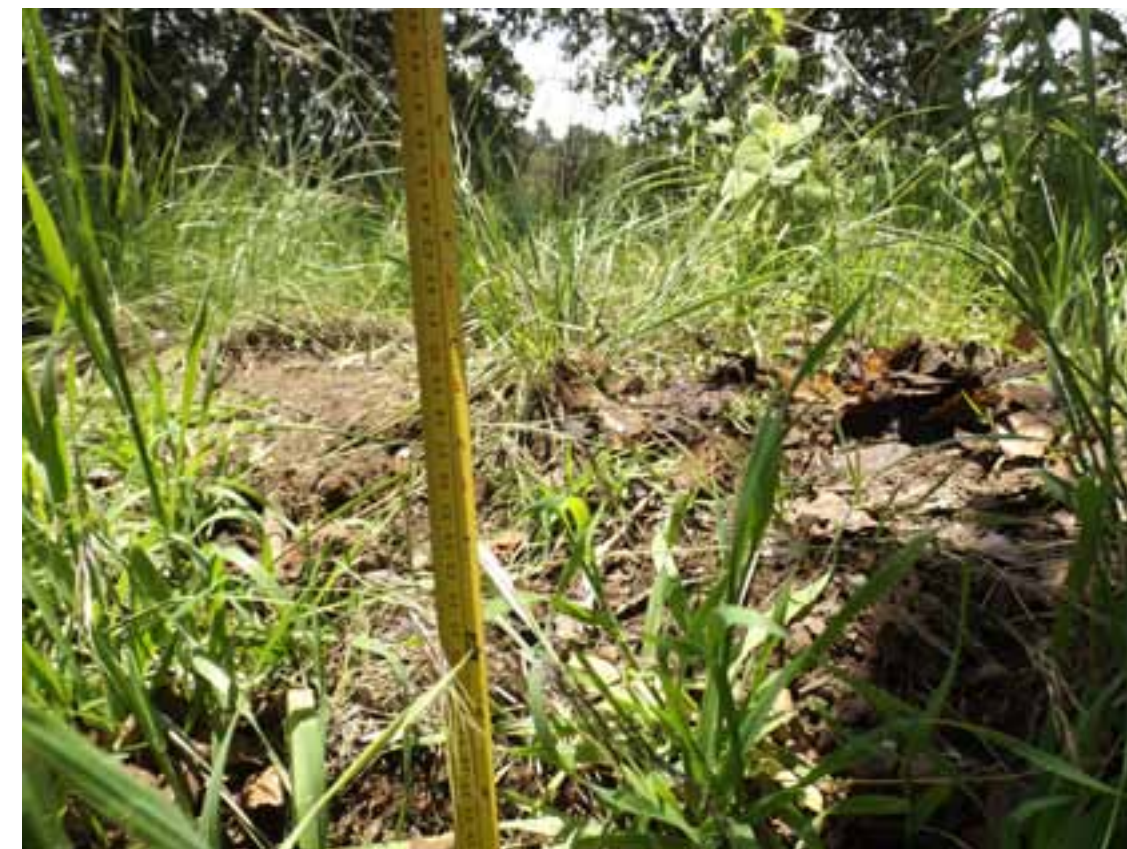
Figura IV.19. Relleno de materia orgánica en la zona agrietada (40 cm de profundidad). También se puede apreciar el alto contenido de humedad sobre el terreno.
