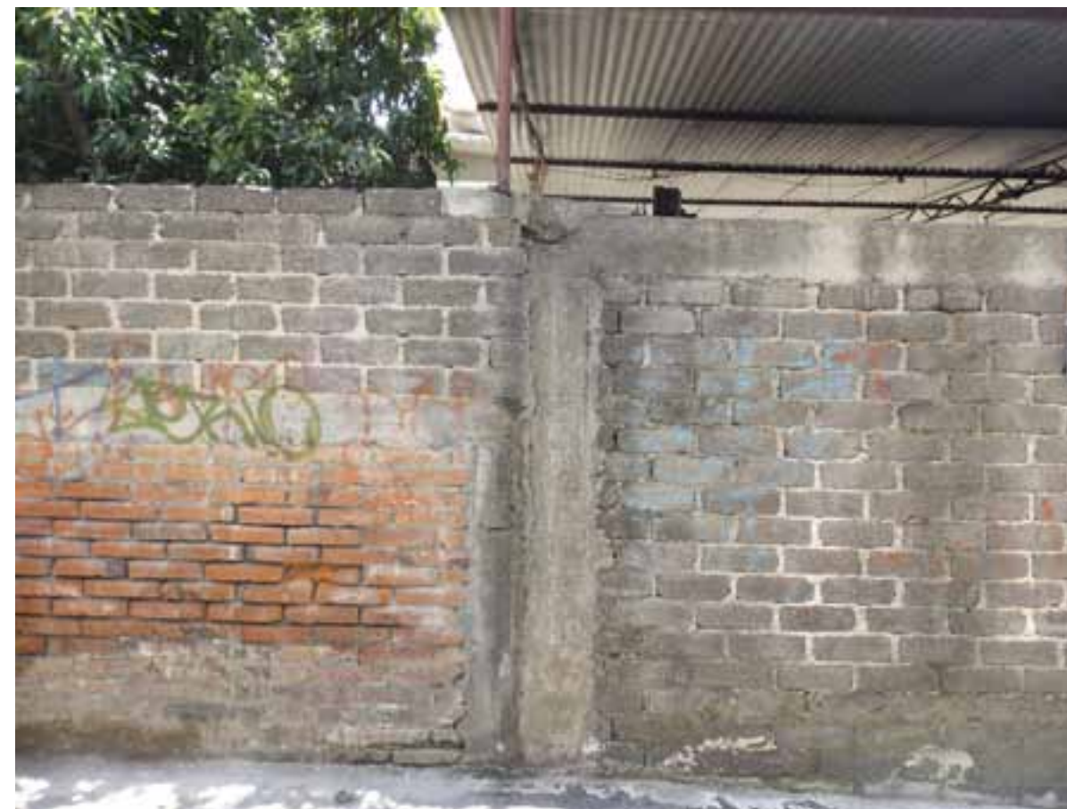
Figura VII.33. Muro de vivienda que presenta diversas etapas constructivas. Los materiales más deleznable como el ladrillo, tienden a presentar mayores índices de erosión al contacto con el agua.
