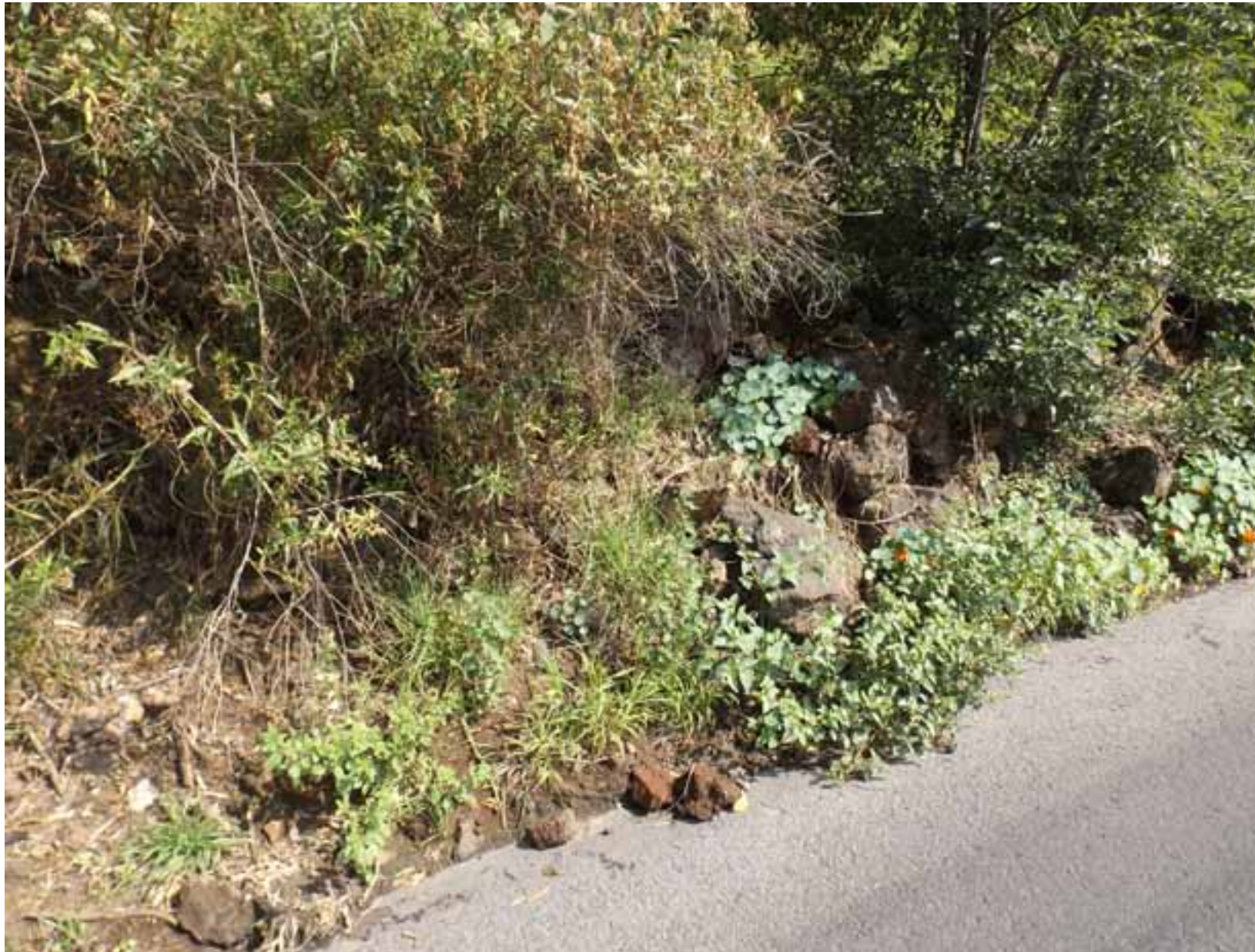
Figura VI.9. Bloques de roca andesítica de diversos tamaños y materia vegetal, depositado sobre la vía de comunicación de "Camino A San Bartolomé Xicomulco".
