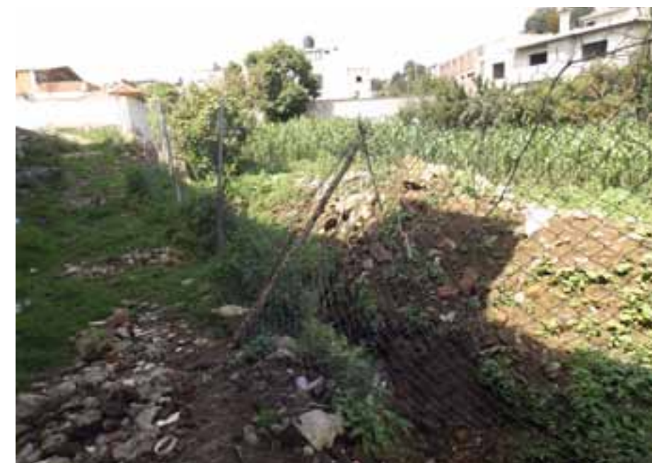
Figura VII.15. Vista panorámica del área hundimiento; a la izquierda un camino colapsado y relleno con material de cascajo y a la derecha el área de cultivo donde actualmente se manifiesta el fenómeno de hundimiento.
