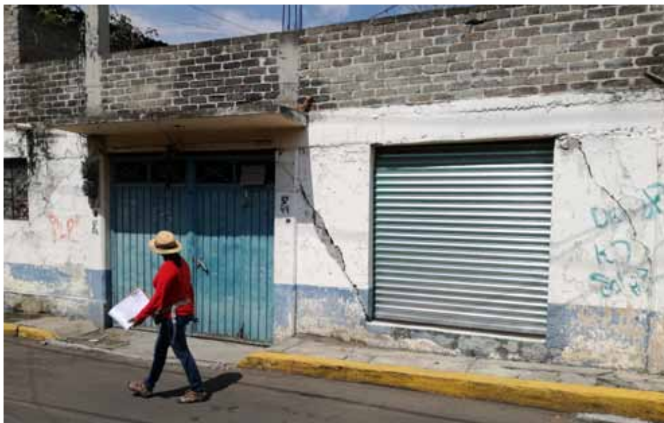
Figura VIII.13 Inmueble con múltiples fracturas diagonal que daña muros de carga y elementos estructurales..
