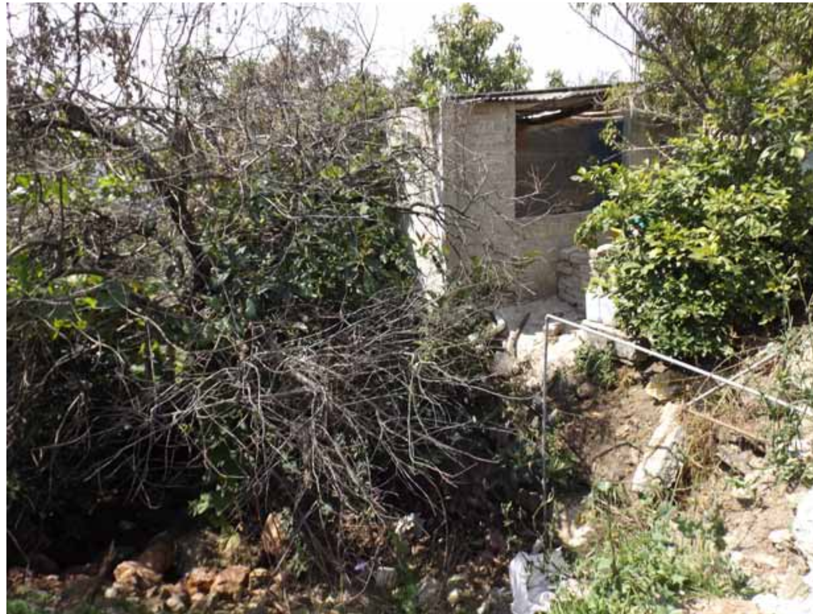
Figura VII.49. Sección de la Barranca Bugambilia, que presenta los índices de susceptibilidad más altos, ya que la zona presenta una pendiente muy pronunciada sobre la cual se aloja una cimentación precaria.
