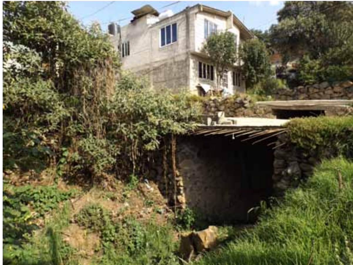
Figura VII.51. Zona de barranca altamente intemperizada y cubierta por una densa capa de materia orgánica. Se observa un obra que busca circundar a la barranca, para poder dirigir la orientación del cauce natural; por encima de esta obra se aprecia una vivienda semiconfinada de dos pisos
