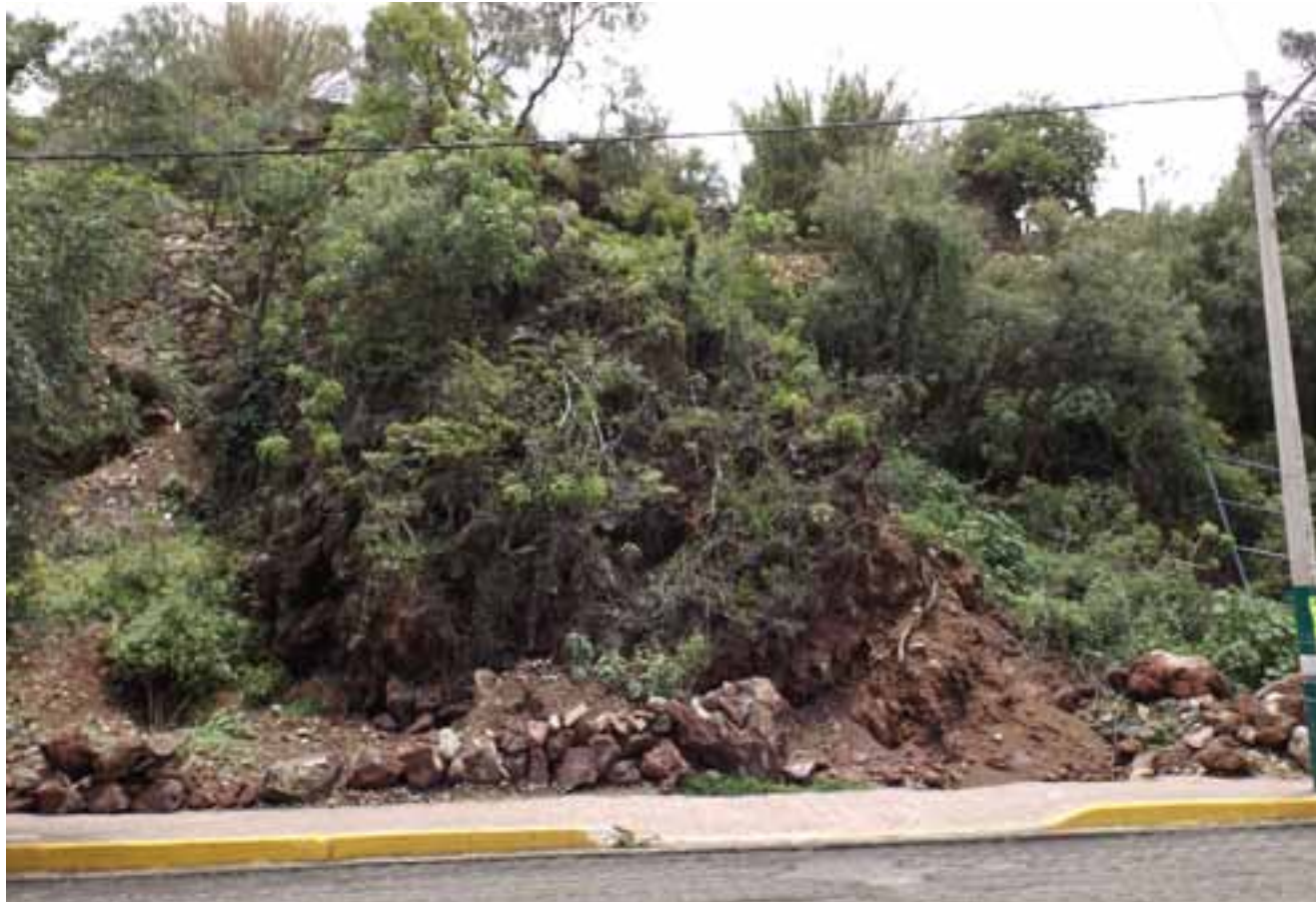
Figura VII.6. Al centro de la imagen se pueden observar las condiciones más representativas del polígono de peligro, esta zona es representada por rocas de 60 cm a 70 cm de longitud. En la parte superior izquierda, un muro de contención de mampostería sin mortero.
