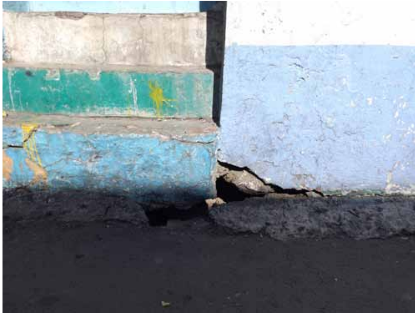
Figura VII.16. Socavamiento presente en la entrada a un inmueble sin confinamiento. La socavación se manifiesta sobre la unión entre el muro y la entrada al inmueble.
