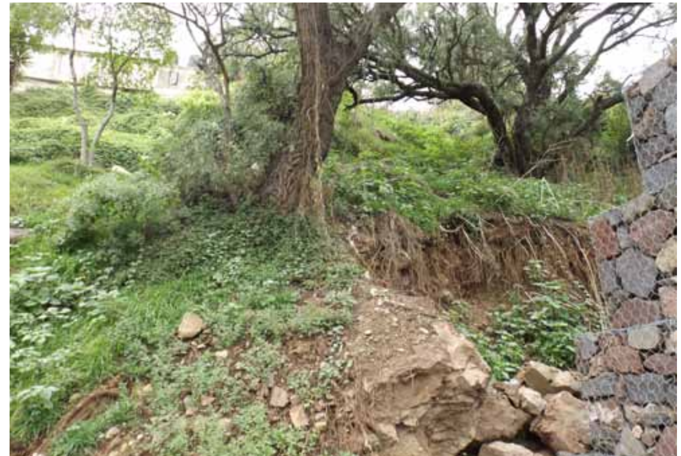
Figura VII.7. Muro de gavión destinado a soportar la caída de rocas que alcanzan dimensiones de 40 cm, se observan un inmueble localizado en la parte superior de la zona de escarpe y el decline de la materia orgánica.
