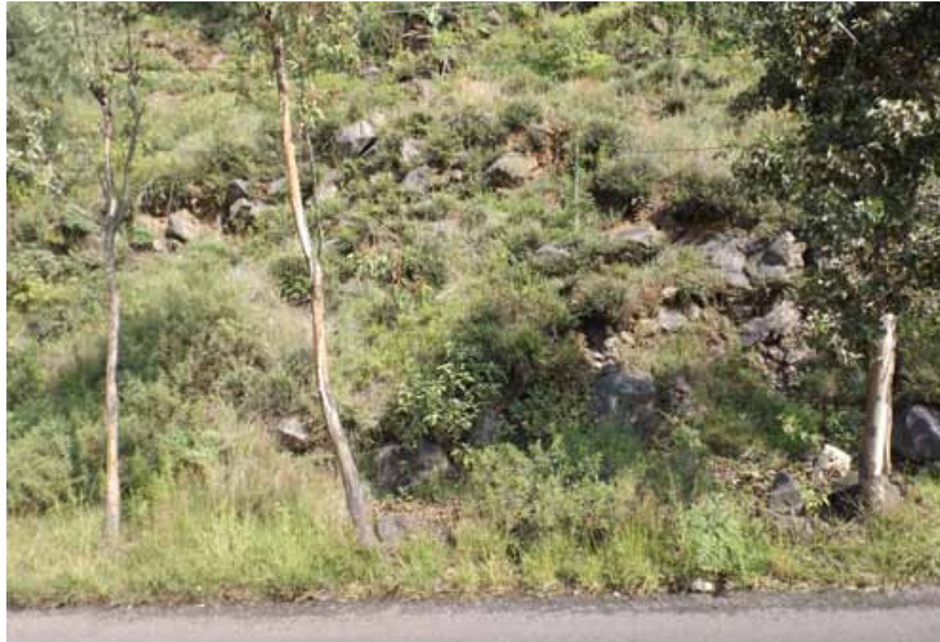
Figura VII.4. Pendiente con bloques expuestos de roca andesítica de 10 cm a 60 cm de diámetro, observada en el tramo carretero San Bartolomé Xicomulco. Se puede apreciar un reacomodo de las rocas a favor de la pendiente.
