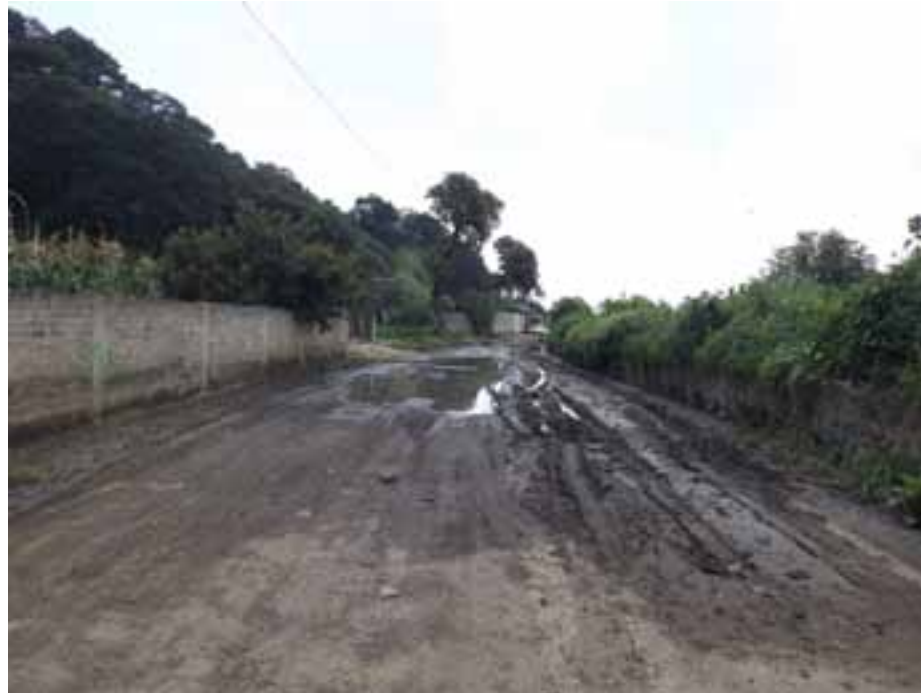
Figura VII.21. Vialidad localizada al noreste del polígono La Joya, donde se observan algunos remaneses de inundación en la zona, además de la importante acumulación de sedimentos en el lugar.
