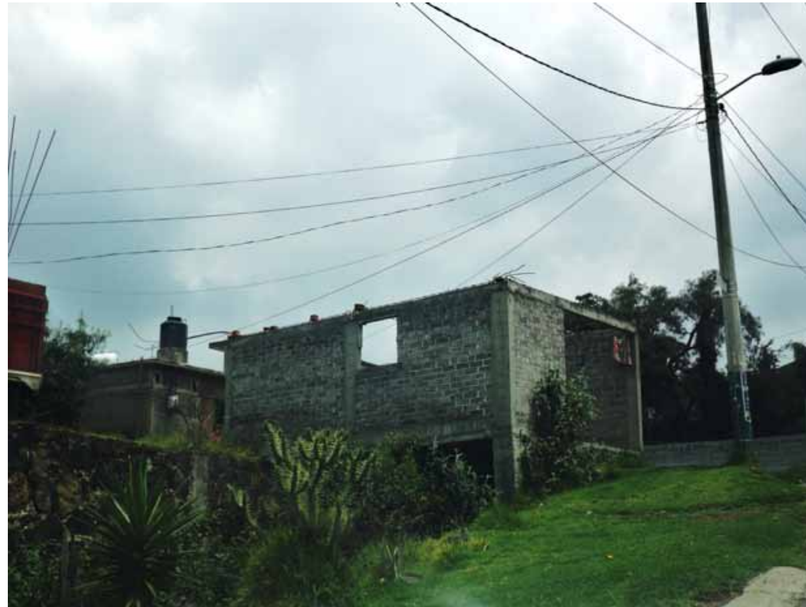
Figura VII.47. Construcción en obra negra, cimentada sobre la barranca. La construcción presenta un espacio de tamaño considerable sobre el cual corre el cauce de la barranca.
