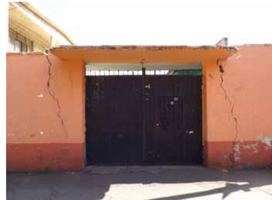
Figura VII.18. Fracturas que siguen una trayectoria desde la carpeta asfáltica en dirección al inmueble, y que afectan al mismo, generando una separación de 2 cm entre sus elementos.
