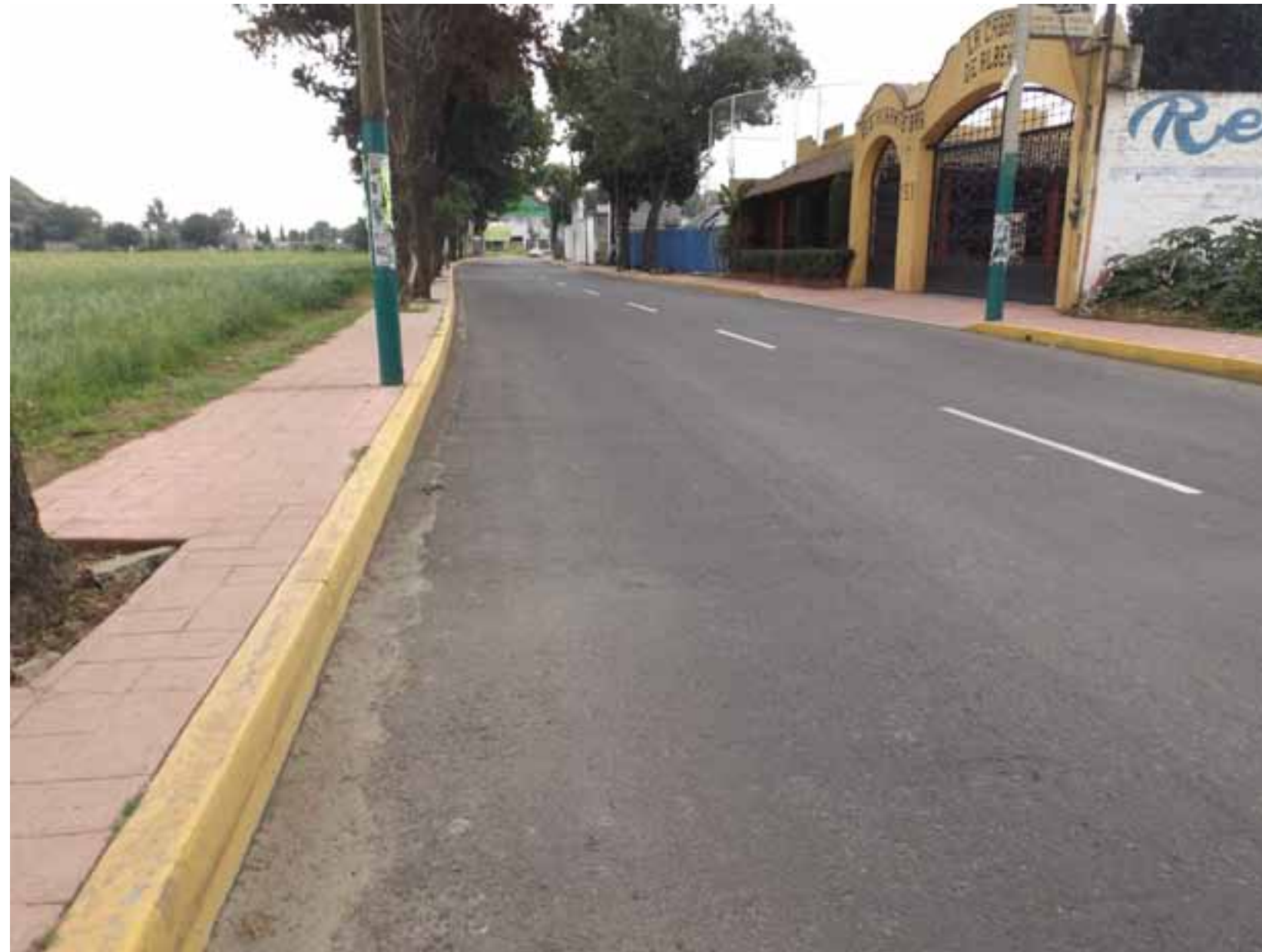
Figura VII.62. Riesgo ante el fenómeno de encharcamiento, donde el nivel máximo alcanzado por la acumulación de agua es de 20 cm.
