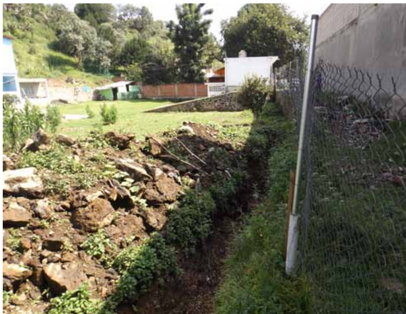
Figura VII.13. Hundimiento de 9 m de longitud; también se observa el material utilizado para el relleno de esta zona.
