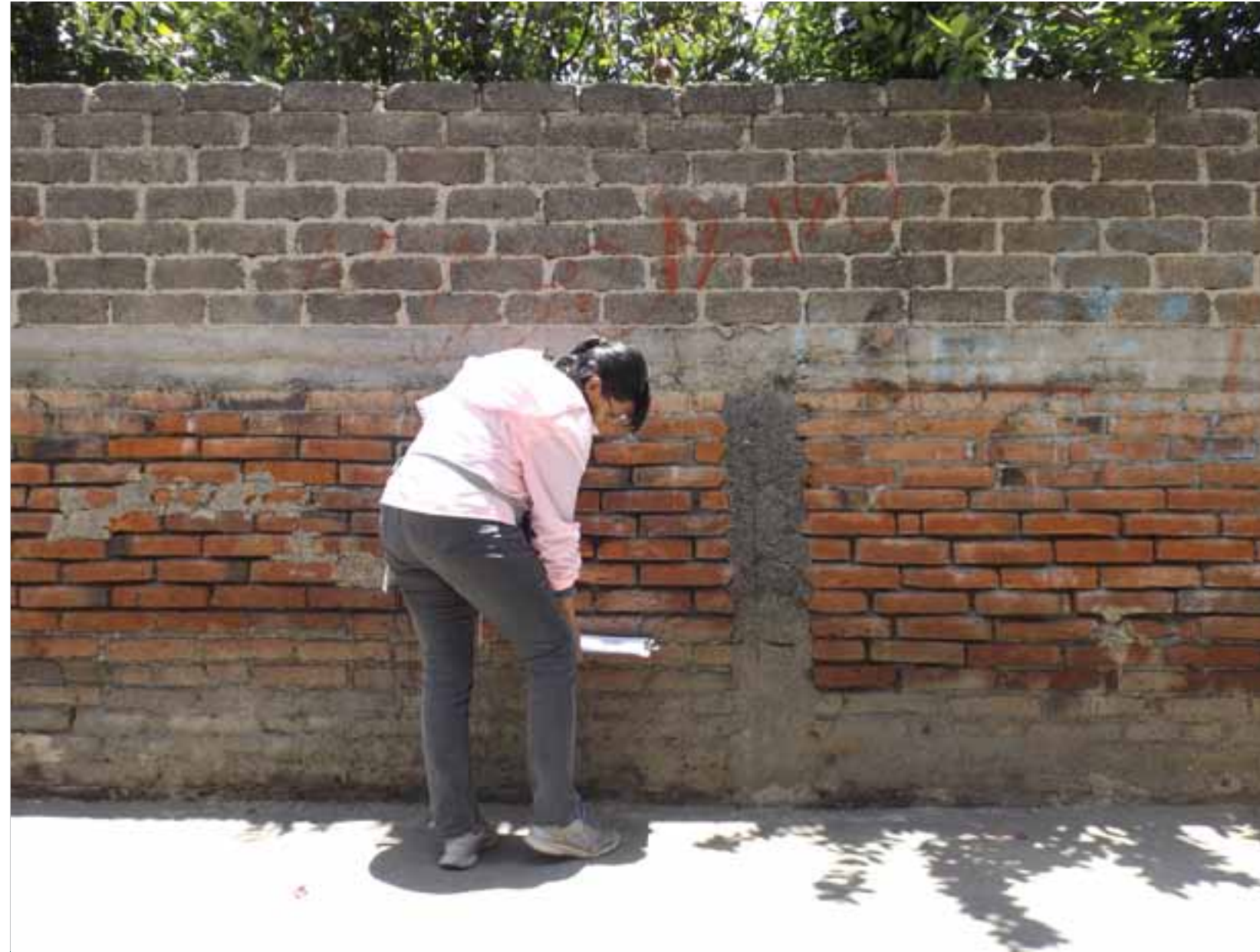
Figura VII.34. Se muestra la evidencia del nivel máximo alcanzado por el agua, y la erosión que esta genera en los materiales del muro.
