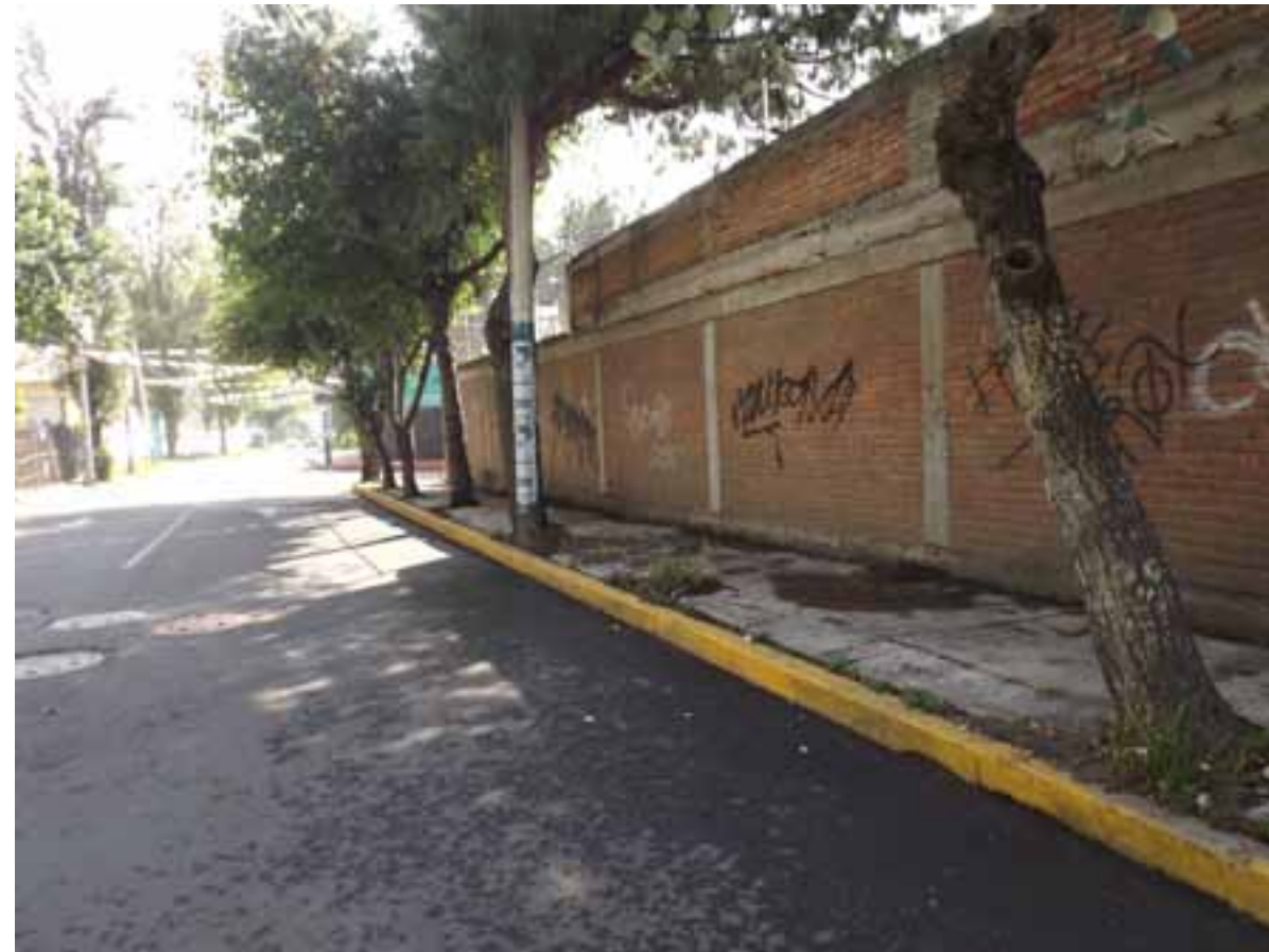
Figura VII.58. Calle Atzayacatl donde se presenta comúnmente el fenómeno de inundación. Frecuentemente los niveles de inundación cubre parcialmente la banqueta.
