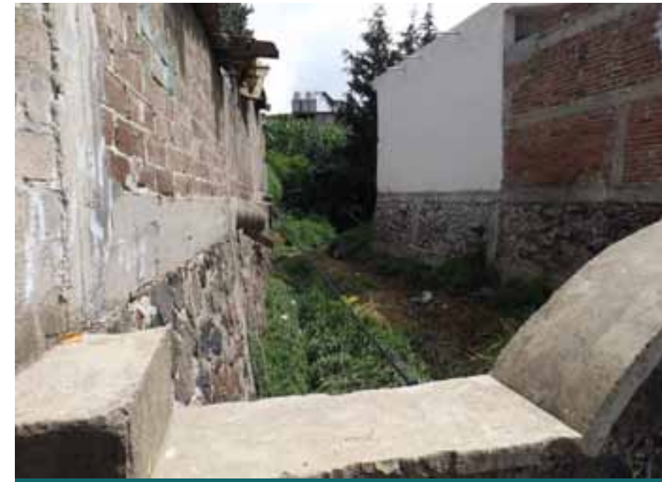
Figura VII.38. Sección del polígono de peligro, donde se observa dos construcciones con cimentaciones de mampostería, ambas estructuras direccionan su salida de agua hacia la zona de peligro.
