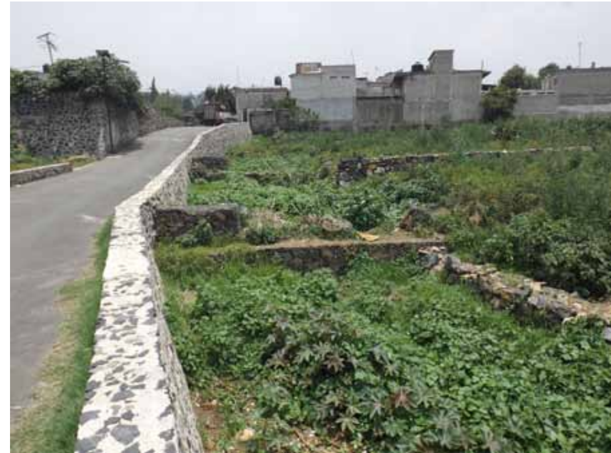
Figura VII.43. Muros transversales a la barranca, conocidas como "obras de control de fondo", que son destinados a reducir el impacto de la corriente, en temporada de lluvias intensas.
