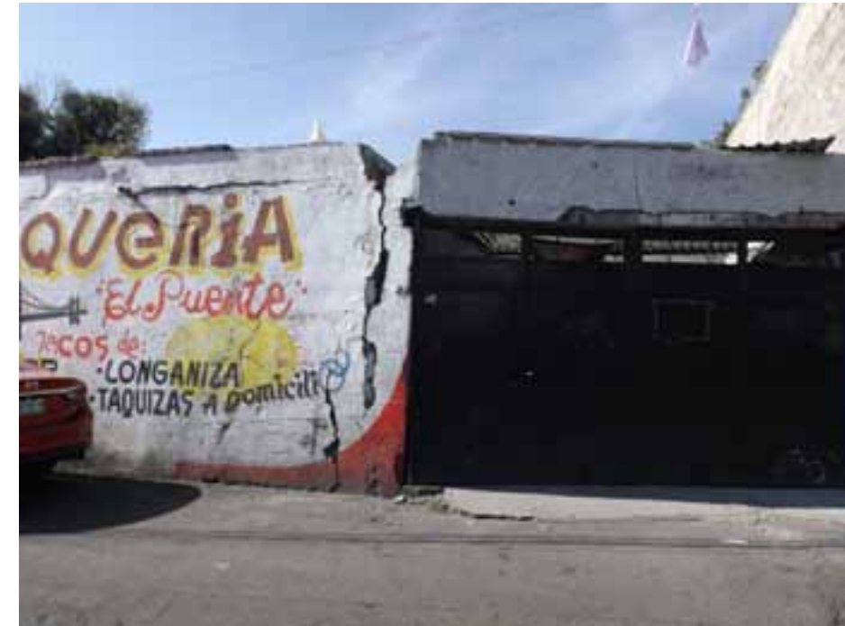
Figura VII.17. Inmueble semiconfinado, altamente fracturado, con elementos desplazados aproximadamente 15 cm.
